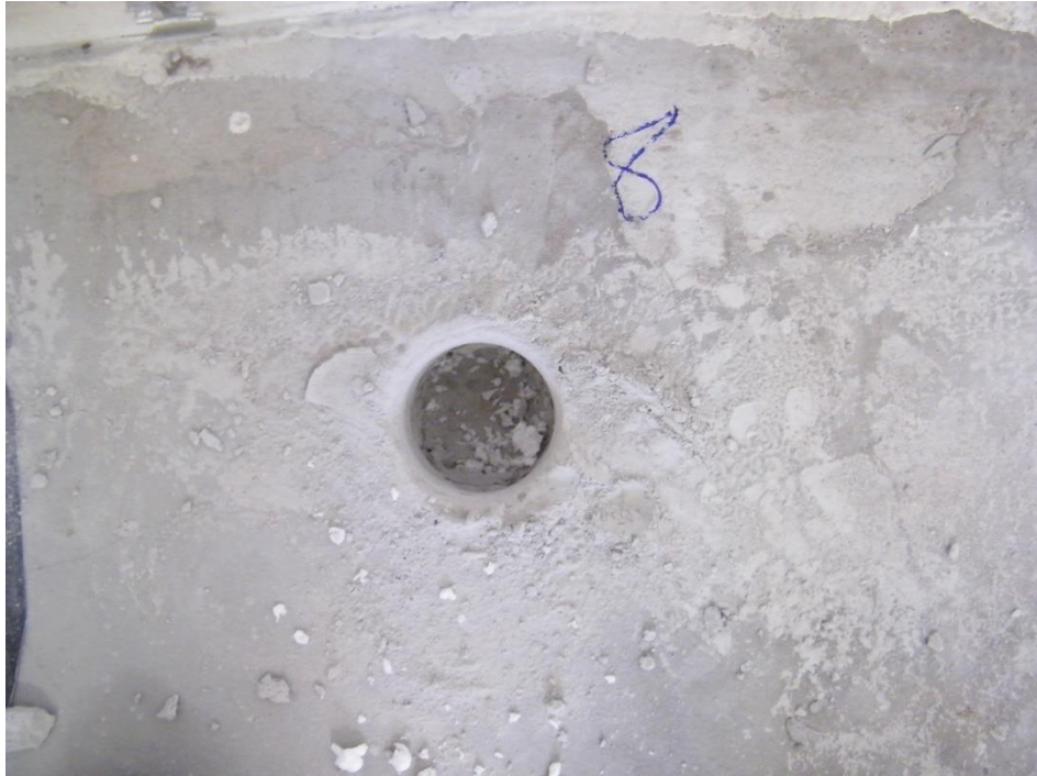
Bild 3 Probe Nr 8. Kernbohrung durch den Estrich.
